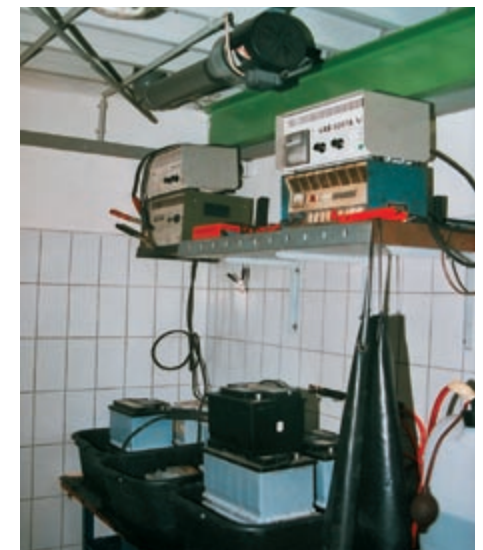
Bild 3-3: Ladestation für Batterien, abgestellt in säurefesten und ableitfähigen Kunststoffwannen. Die Ladegeräte stehen auf einer nicht brennbaren Konsole.
