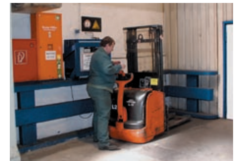
Bild 4-4: Einzelladeplatz für ein Mitgänger- Flurförderzeug
