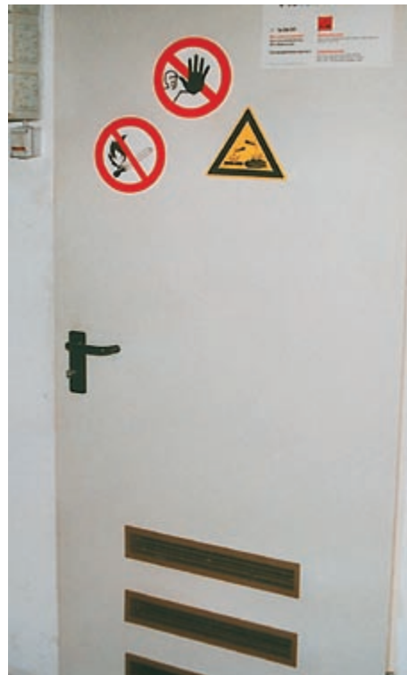
Bild 3-4: Lüftungsgitter zur natürlichen Lüftung in der Zugangstür einer kleinen Ladestation für Pkw-Starterbatterien.
