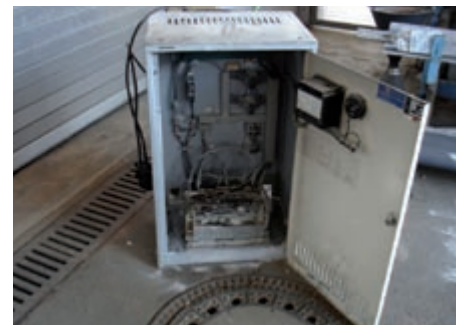
Bild 7-7: Durch Brandschaden zerstörtes Batterieladegerät
