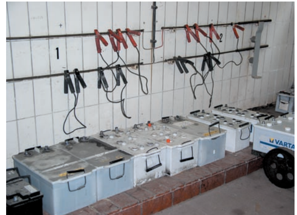
Bild 3-8: Blick in den Batterieladerraum einer Nutzfahrzeug-Werkstatt
