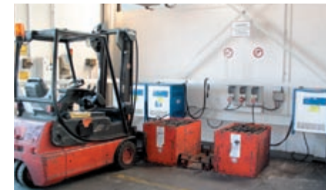
Bild 3-6: Ladestation für Flurförderzeuge und deren Wechselbatterien in einer Werkhalle mit natürlicher Lüftung
